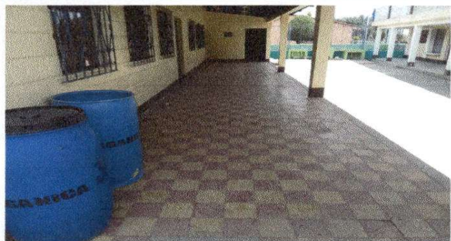
Foto 1: Sustrucción de piso de granito
